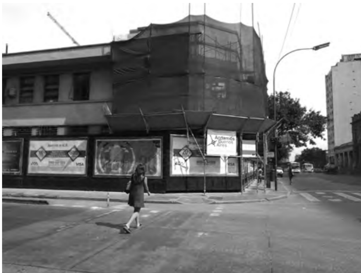
Escuela Isauro Arancibia, febrero de 2018: el sector de obra que aparece cubierto está en proceso de demolición para permitir el ensanche de la avenida Paseo Colón y dar lugar a la prolongación del Metrobús.
